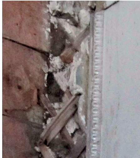
Илл. 6. Будуар. Фрагмент штукатурки. Фото О. Е. Галаничевой, 2014–2021 гг.
